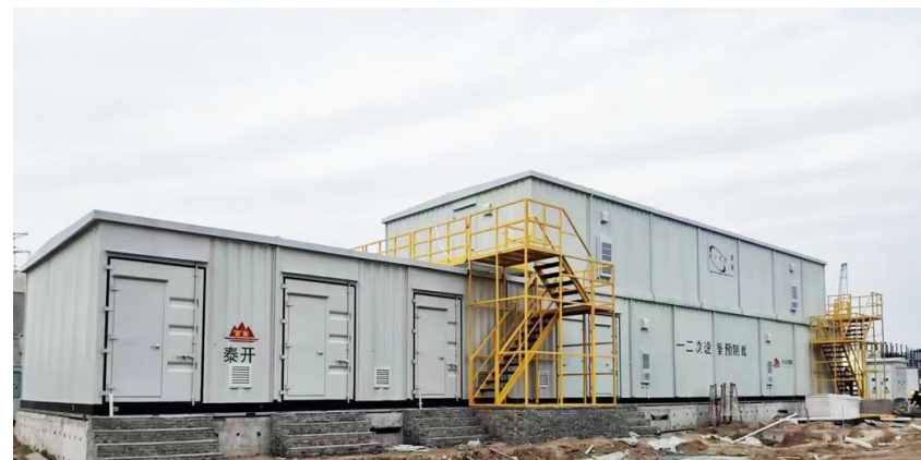
2022年12月 濮阳盛源能源科技股份有限公司 110kV变电站新建工程PC总承包项目
