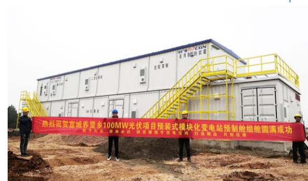
2020年12月（宣城）养贤乡 100MW光伏项目
