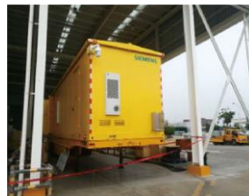
西门子内蒙古呼和浩特110kV车载移动变电站
