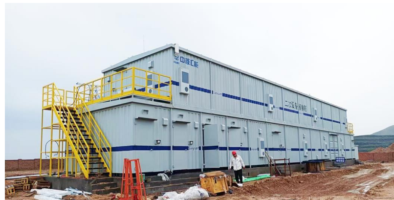
2022年5月 山西稷山汇能权亚100MW光伏项目
