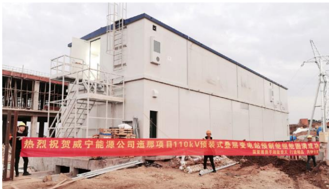
2019年11月 贵州省威宁县 迤那110kV装配式集成升压站
