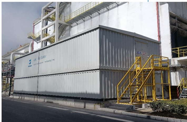
2022年9月 河海综合智慧能源项目
