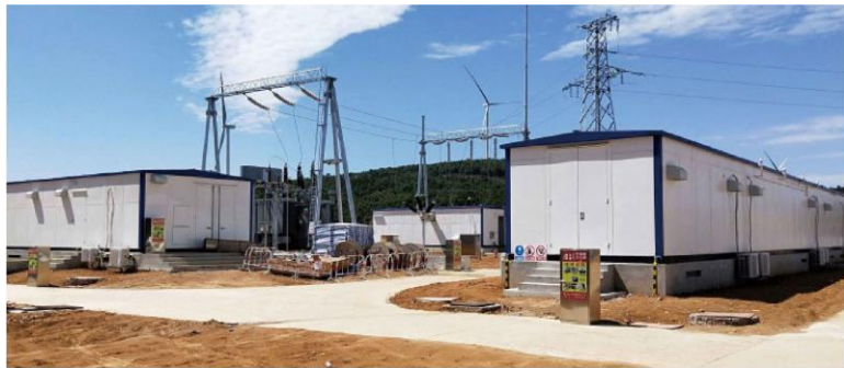
风电场35kV变电站预制舱
