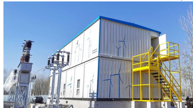
2021年11月 华能夏邑县 韩镇32MW分散式风电项目
