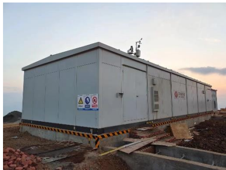
分布式光伏10kV二次设备一体舱
