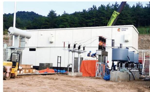
2020年8月 平遥变电站项目
