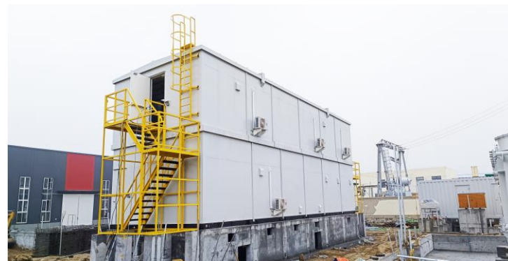
2022年9月 德州陵城区徽王庄50MW风电项目
