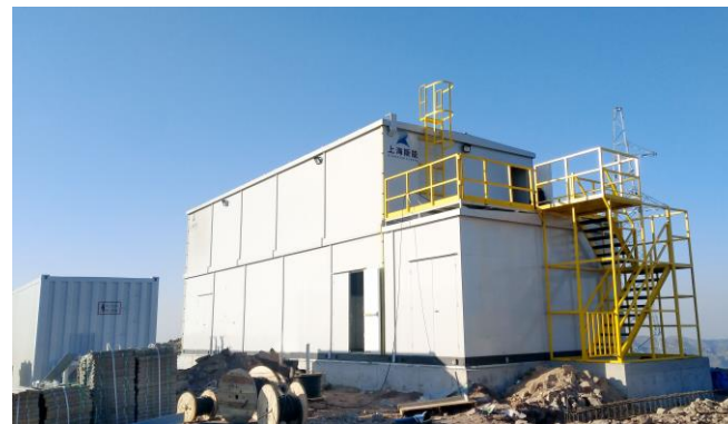
2021年12月 祁县盘陀10MW分散式风电项目
