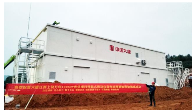
2020年12月 大唐江西上饶 万年100MW光伏项目
