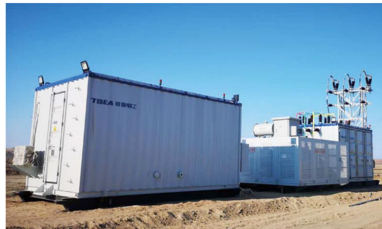
新疆天池移动变电站
