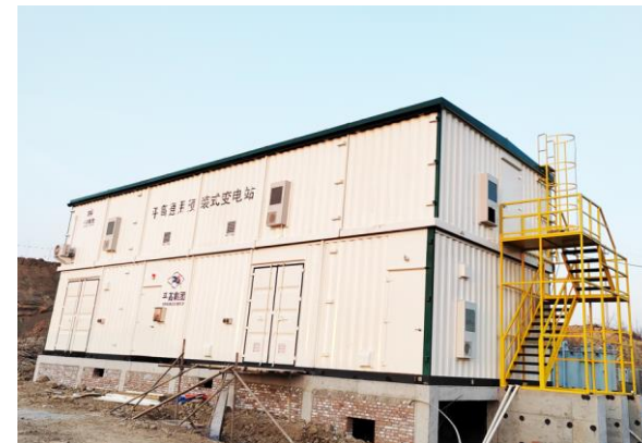
2022年12月 南召东升新能源有限公司马市坪 一期40MW风电场项目
