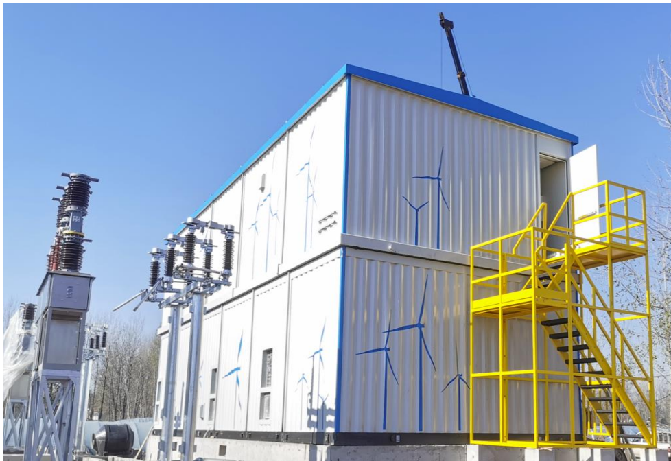
华能夏邑风电场项目220kV升压站
