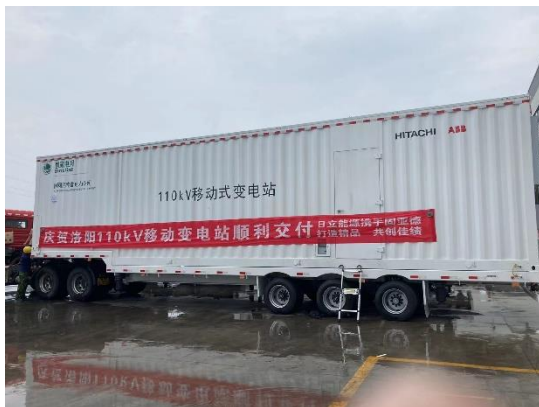
ABB洛阳110kV移动站
