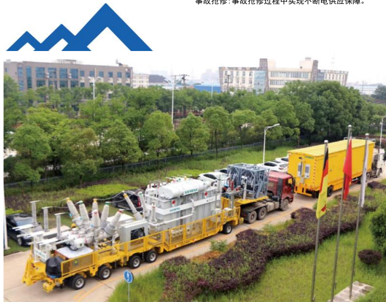
110kV车载移动变电站
