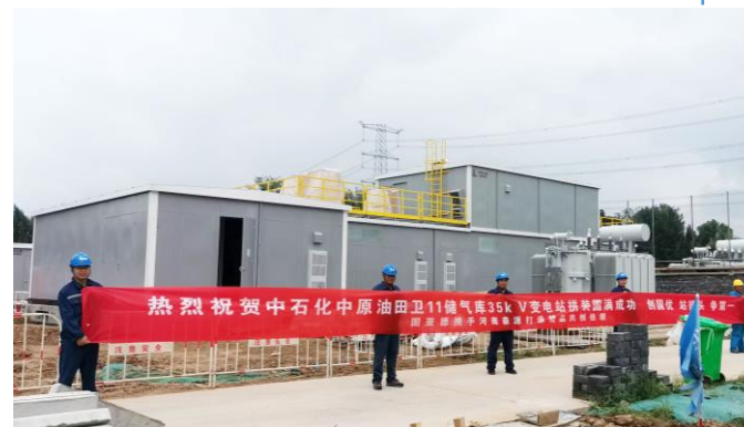
2021年7月 卫11储气库35KV预制舱式变电站
